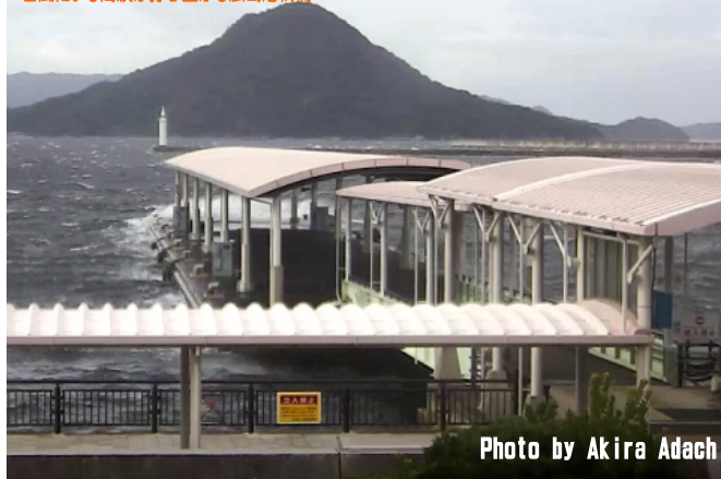
台風による高波が打ち上がる広島港桟橋
